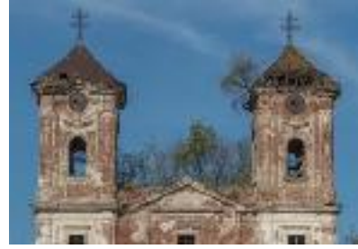
Fig. 6. Șarpantă și învelitoare degradată.
