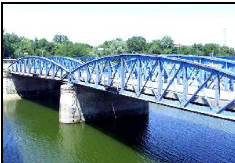
Fig. 2. Podul combinat (rutier și de cale ferată), peste Canalul Sf. Gheorghe din Giurgiu.
