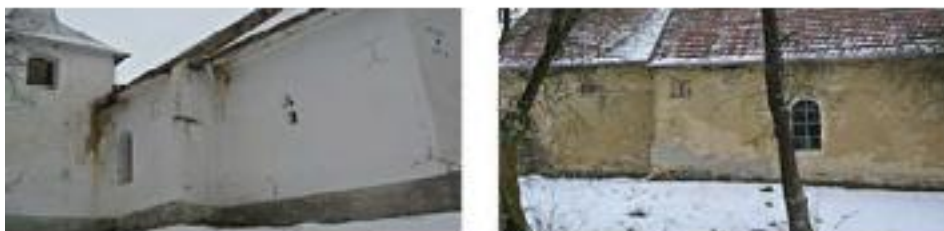
Fig. 6. Degraderi ale fatadei de nord și sud.
