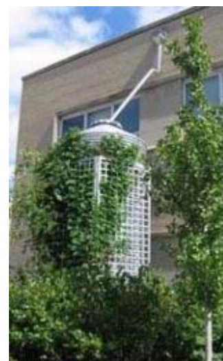
c. Colectarea apei pluviale
